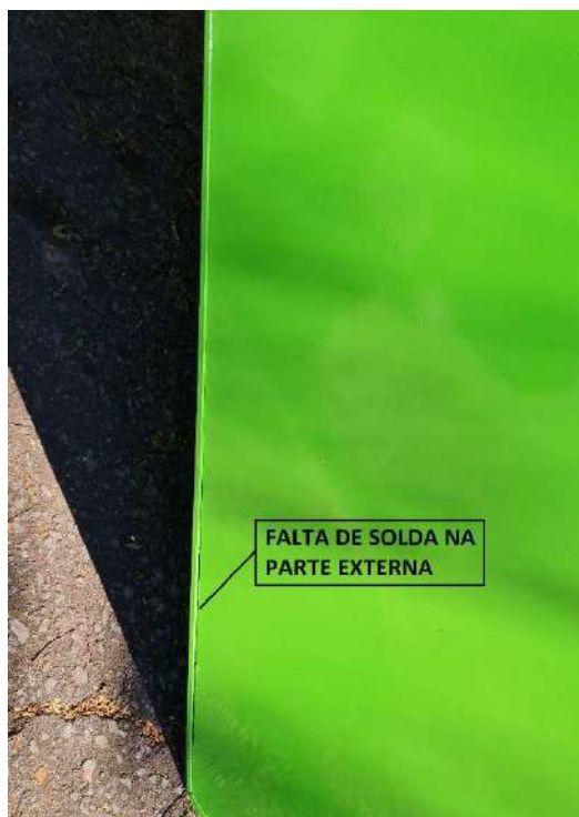
FOTO Nº 02 – falta de solda na parte externa
