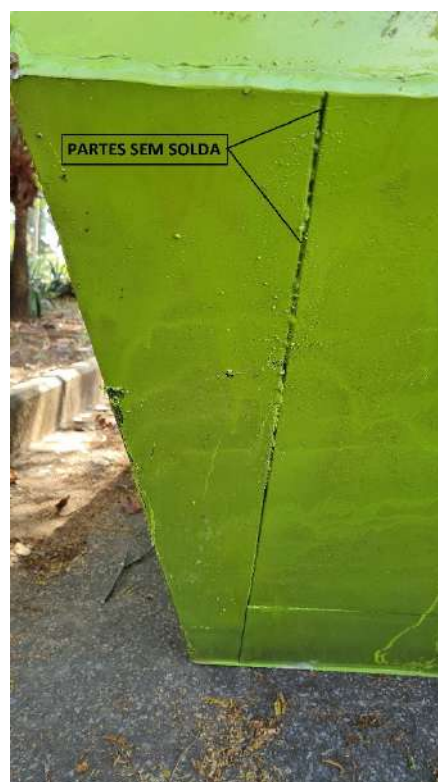
FOTO Nº 03 - partes sem soldagem
