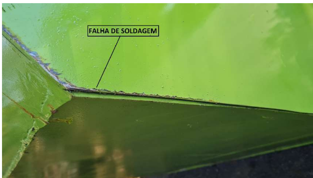
FOTO Nº 04 – falhas de soldagem
