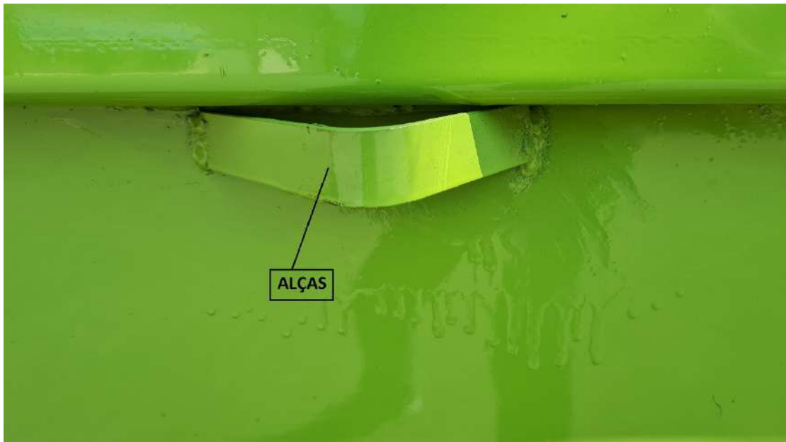
FOTO Nº 09 – uso de alças ao invés de ganchos, em desacordo com as especificações
