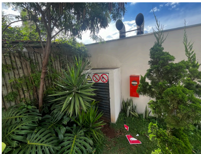
Área externa: sistema de exaustão e abrigo de gás. Fonte: DO AUTOR, 2026.
