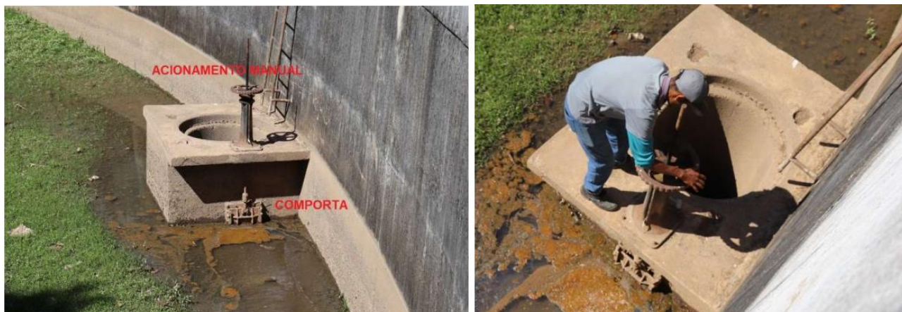
Figura 5.1. Comportas manuais instaladas nas laterais da Tulipa (Fonte: PSB Volume IV / SUDECAP, 2021).
