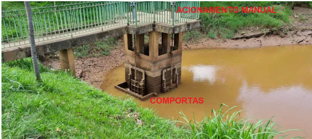
Figura 5.1. Comportas manuais instaladas nas laterais da Tulipa (Fonte: PSB Volume IV / SUDECAP, 2021).
