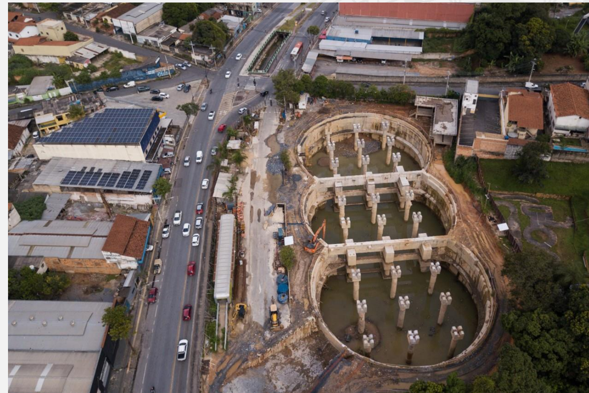
Reservatório Profundo- Vilarinho
