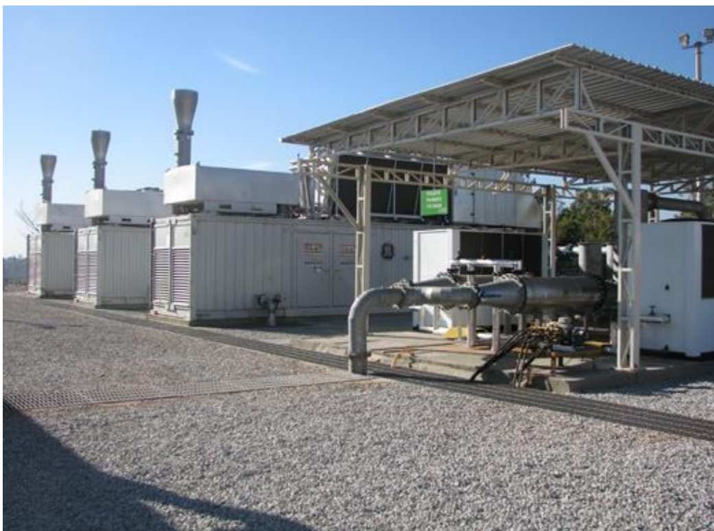
Figura 17: Central de aproveitamento energético do biogás
