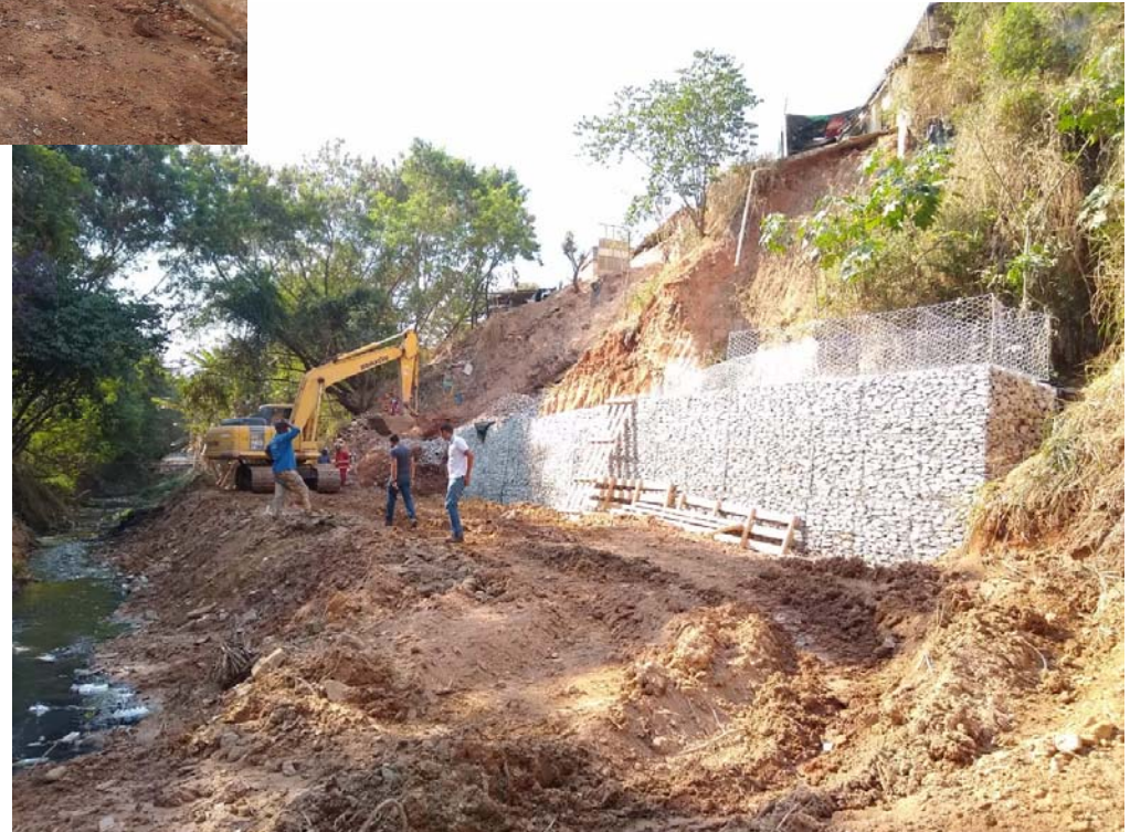
Contenção de encosta do Córrego da Rua Joaquim Clemente – B. Xodó-Marize
