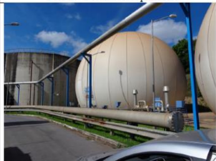
Foto 4 – Balões de armazenamento de biogás
