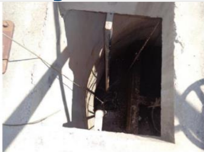
Foto 3 Ausência de tampas nos poços de sucção da EEE Barroquinha
