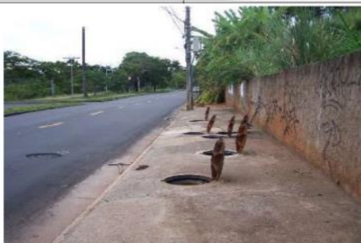
Foto 3 ETE fora de operação
