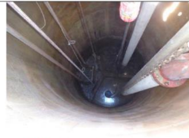
Foto 4 ETE Cachorro Magro com problemas no acionamento das bombas
