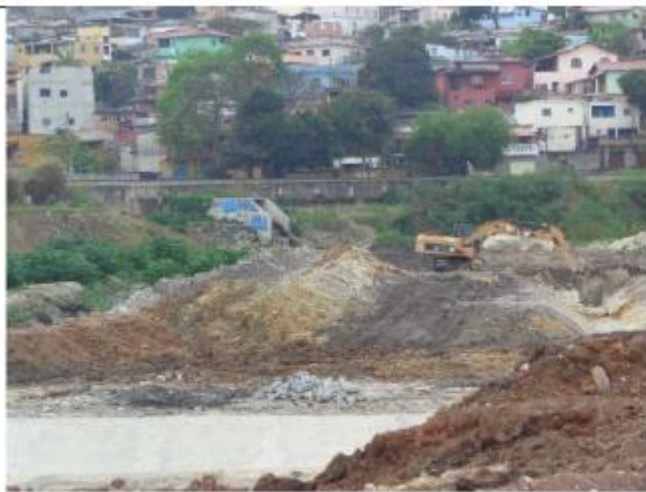
Foto 1 Obras na margem esquerda. Esgoto ainda lançado no canal de água fluvial
