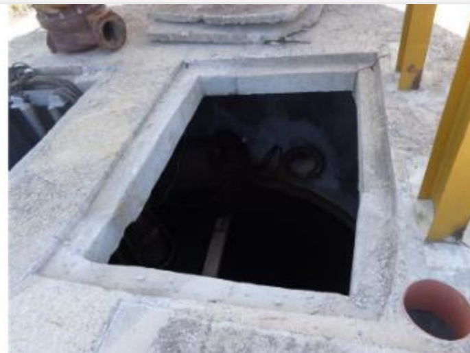
Foto 4 Ausência de tampas nos poços de sucção da EEE Estaleiro
