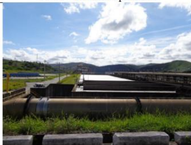
Foto 3 – Reatores aeróbicos de lodos ativados
