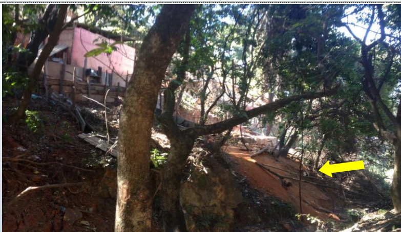
MATERIAL PROVENIENTE DA REGULARIZAÇÃO DO TALUDE E INÍCIO DAS CONTRUÇÕES LANÇADO JUNTO AO CÓRREGO
