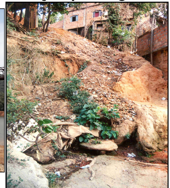
Erosão do solo
