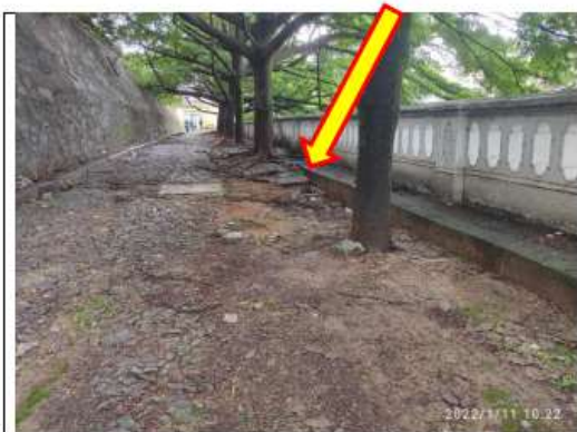
Figura 4 – Dispositivo de drenagem.
