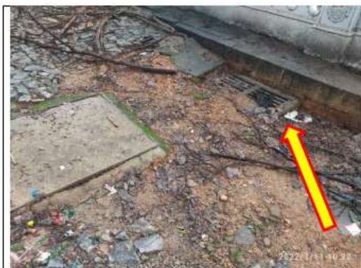
Figura 6 – Dispositivo de drenagem.
