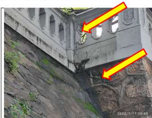
Figura 14 – Trinca no muro de arrimo, abaixo dos balaústres do guarda-corpo.
