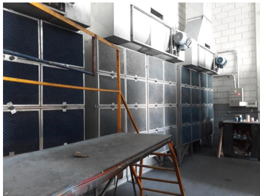
Figura 4 – Área de pintura.
