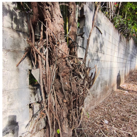
Foto 4.1 - Complexo arbustivo de pequeno porte em conflito com o muro, com ataque de praga e ramos quebrados
