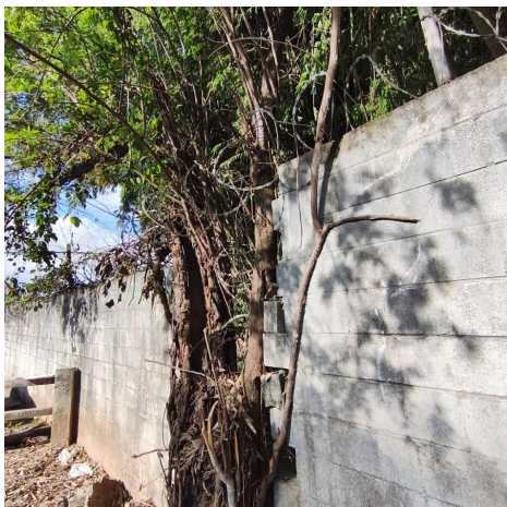
Foto 4 - Complexo arbustivo de pequeno porte em conflito com o muro, com ataque de praga e ramos quebrados
