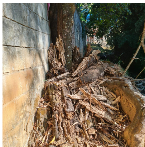
Foto 5.1 - Árvore secando de grande porte (NID) em conflito com muro que foi danificado com a queda de galhos
