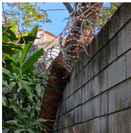
Foto 2.1 - Leucena de grande porte danificando o muro do condomínio/alta inclinação/risco de queda/secando
