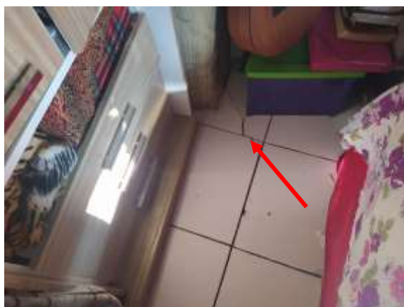
Figura 2 – danos no imóvel
