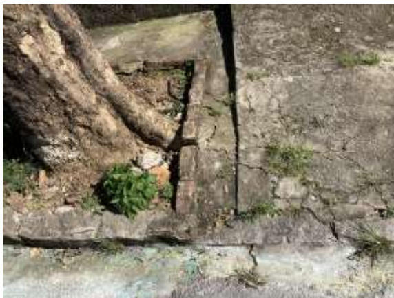
Figura 1 – danos no piso do passeio causados pelo sistema radicular do ipê amarelo
