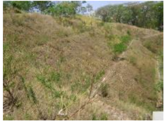
Foto 8 – Detalhes dos taludes, canaletas de drenagem e cobertura vegetal com forrações e plantio de mudas nas cristas.
