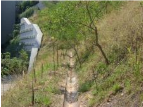
Foto 9 – Detalhes dos taludes, canaletas de drenagem e cobertura vegetal com forrações e plantio de mudas nas cristas.
