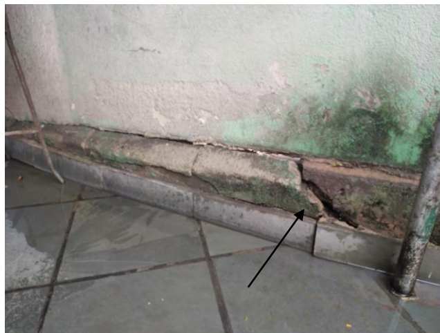
Figura 2 – danos físicos no muro vizinho causados pelo sistema radicular do ipê-cascudo
