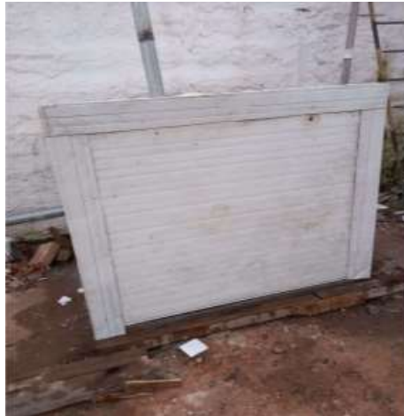
Figura1: Fotografia da proteção acústica instalada pela empresa na bomba hidráulica (fonte: Hipercarnes, ticket BHdigital31.00573232/2022-11)
