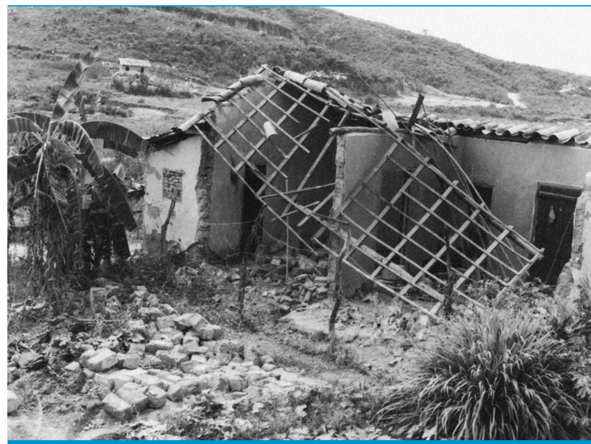
Imóvel danificado pelas águas da Pampulha. — Acervo APCBH/ Fundo da Secretaria Municipal do Tesouro
