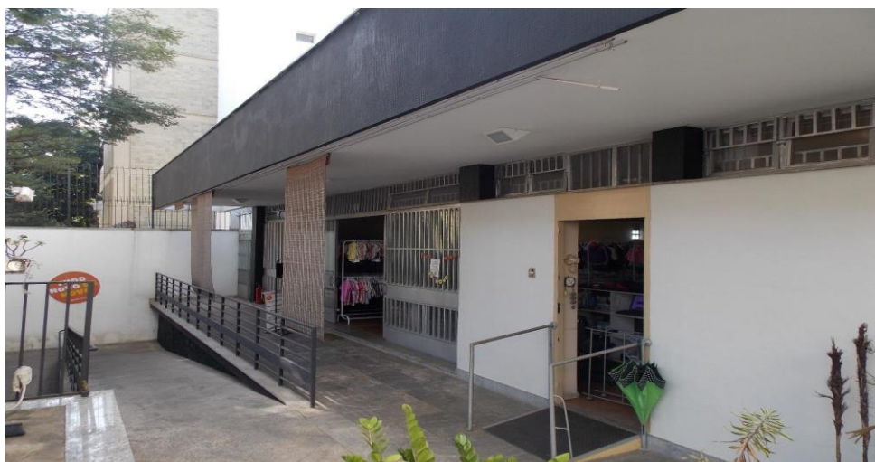
Figura 55: Vista da varanda frontal da edificação que passou por intervenções que retiraram os painéis de jacarandá (macho e fêmea) que fechava a porta de entrada, à direita, e pintaram de preto as pastilhas esmaltadas brancas do beiral existentes no projeto aprovado. Houve também alteração na rampa de acesso, provavelmente para promover a acessibilidade da edificação. Fonte DPCA, 2022.
