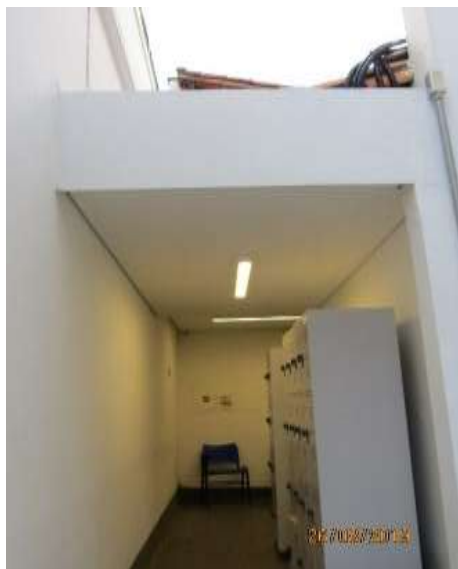
Porção posterior esquerda do nível térreo. Fonte: Vistoria DPCA 26/08/19.
