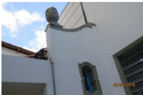
Afastamento lateral esquerdo. Fonte: Vistoria DPCA 26/08/19.
