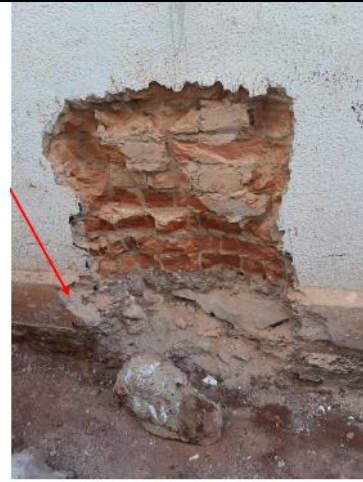
Figura 02: Detalhe da prospecção realizada junto ao baldrame mostrando que a saliência em relação ao plano da parede corresponde ao engrossamento da argamassa de revestimento. Data: 30/07/2020. Fonte: Memorial Descritivo.
