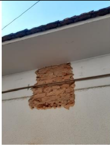
Figura 01: Detalhe da prospecção realizada junto ao beiral mostrando a inexistência de viga de cintamento superior. Data: 30/07/2020. Fonte: Memorial Descritivo.
