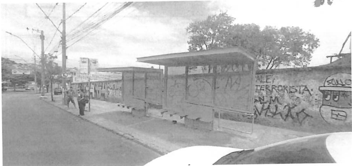
Cor do abrigo fora do padrão (PISO TÁTIL CONCLUÍDO)
