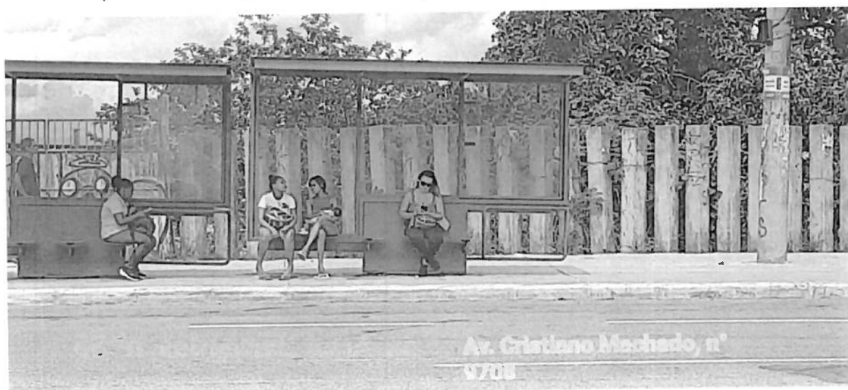
Sem sinalização horizontal de piso tátil
